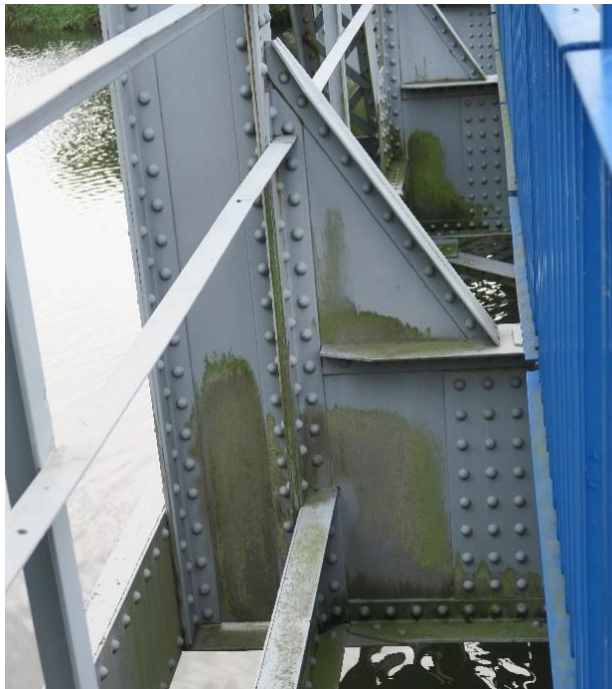
Foto 2. Fläckvis bevaxning på balkar under körbanan.
